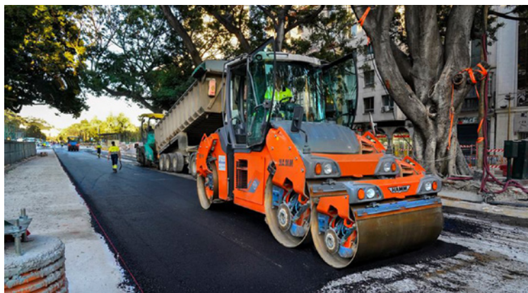
Figura 11. Fotografía de trabajos de asfaltado de Alameda Principal en Málaga, trabajos del Metro de la ciudad.
