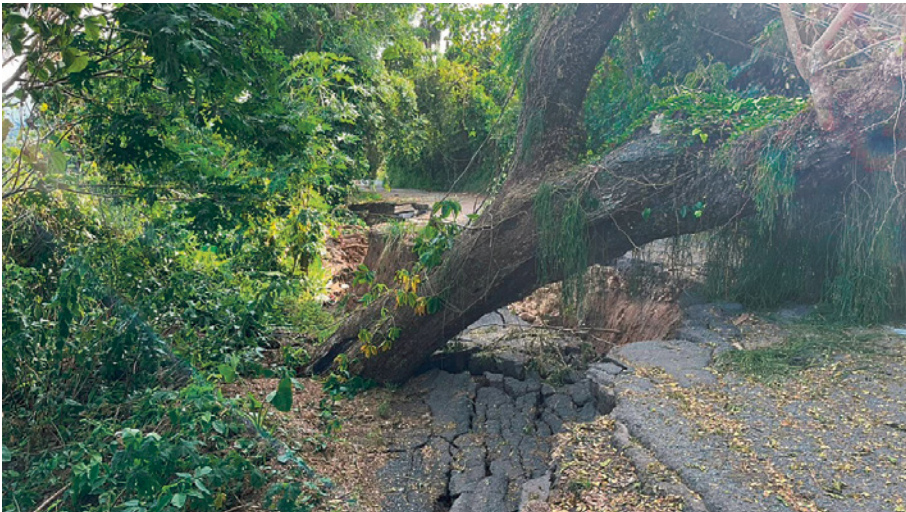
Figura 5. Desplome parcial de la carretera PR-159, Morovis, Cordillera Central de Puerto Rico. 23 de septiembre 2022.
