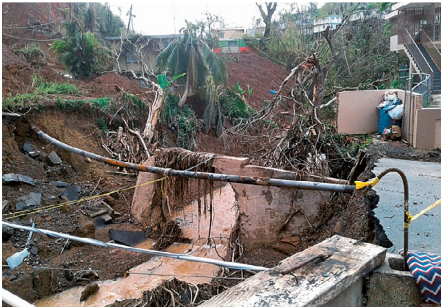
Figura 4. Derrumbe de la carretera PR-152 en el Poblado de Barranquitas. Cordillera Central, Puerto Rico, 24 de septiembre 2017.
