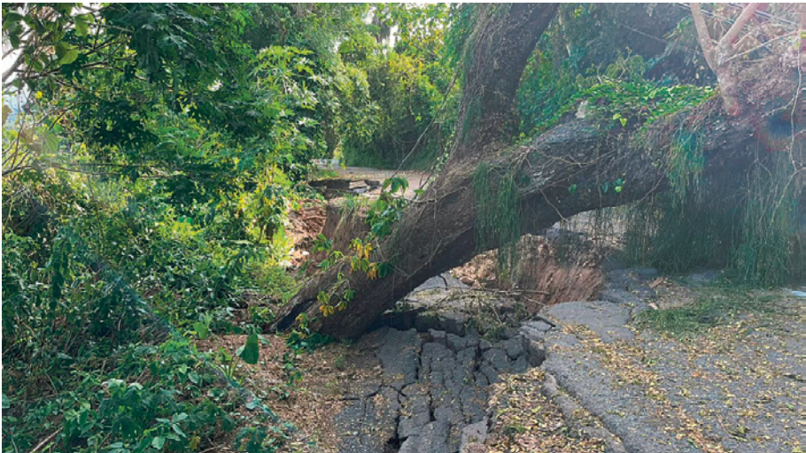
Figura 5. Desplome parcial de la carretera PR-159, Morovis, Cordillera Central de Puerto Rico. 23 de septiembre 2022.
